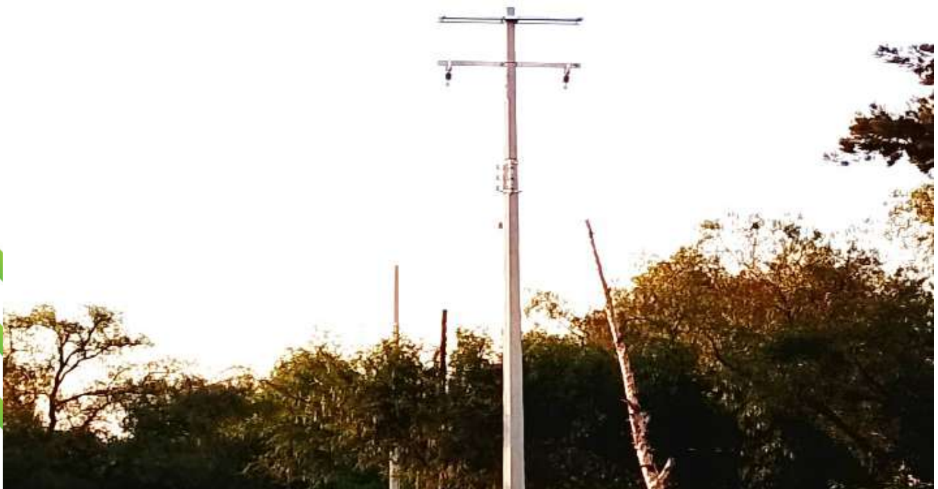
Electrificación calle La Canaleta
